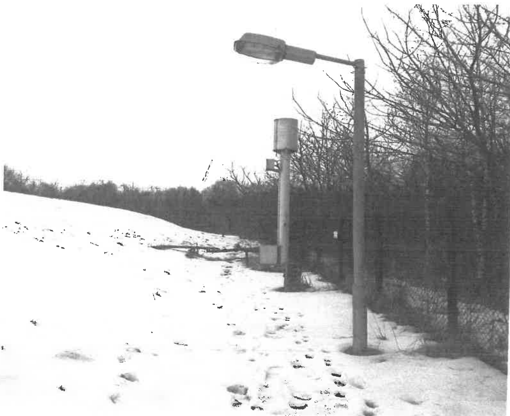
Zdjęcie punktu nr 8 Punkt spalania gazu składowiskowego.
